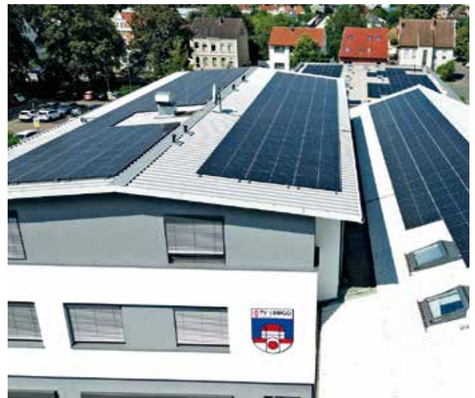
Die 240 Solar-Module auf den Sportanlagen des TV Lemgo helfen beim Klimaschutz und machen die Vereinskasse unabhängiger von steigenden Stromkosten. (Foto: Stadtwerke Lemgo GmbH)
